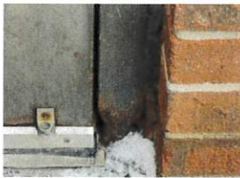
Rear Door Rust
