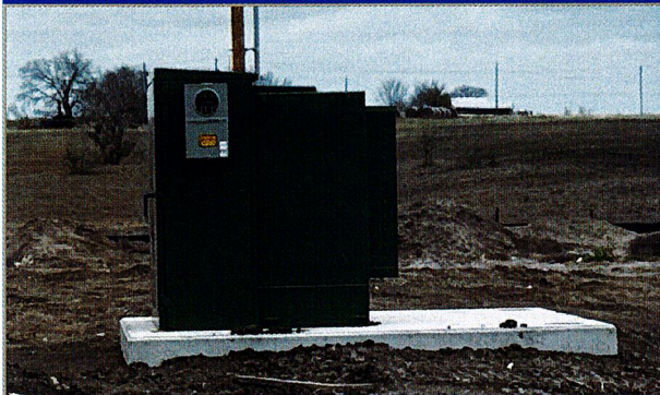
Electrical Transformer - Site (03.05.2026)
